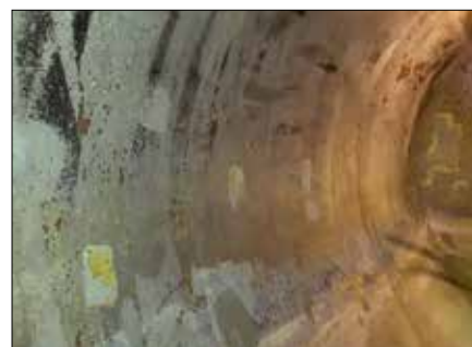
Fot. 5. Uszkodzenia tradycyjnej powłoki zabezpieczającej wewnętrzną powierzchnię zbiornika (archiwum firmy Compact-Project)
